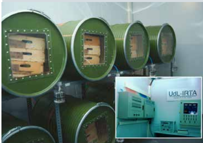
Els avenços en control informatitzat dels gasos van permetre construir la complexa instal·lació de microcambres del centre UdL-IRTA.
